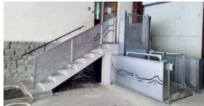
Ascenseur PMR installé à l'école du Centre
