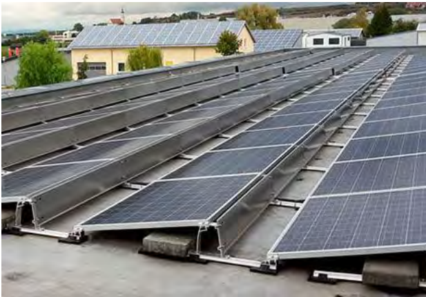
Figure 7 – Fixation des modules sur rails lestés
