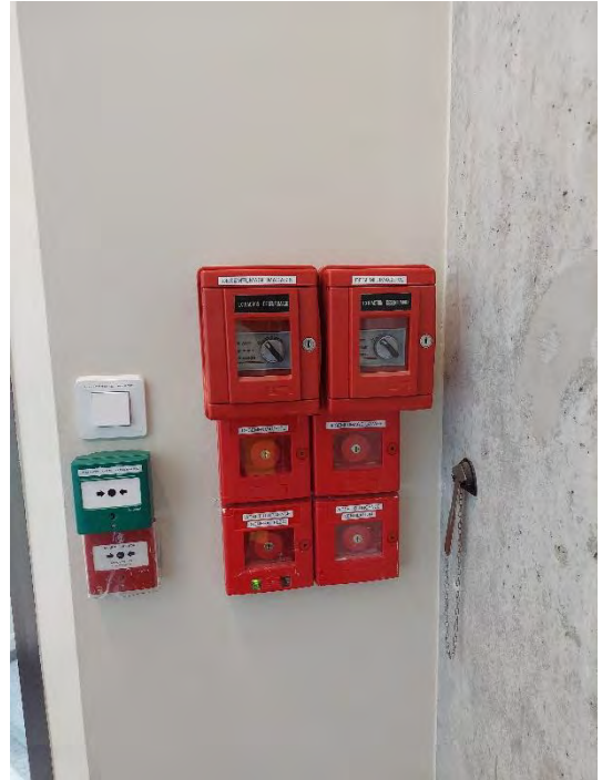
Figure 10 – Photo des arrêts d'urgence existants, situés à l'entrée Nord
