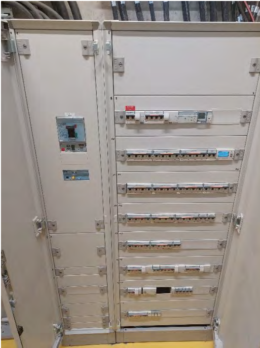
Figure 11 – Photo du TGBT situé au R-1
